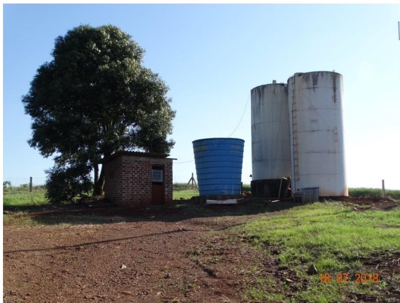
Figura 5. Visualização dos reservatórios de água da área urbana e do setor de tratamento da água do município de Centenário/RS.
